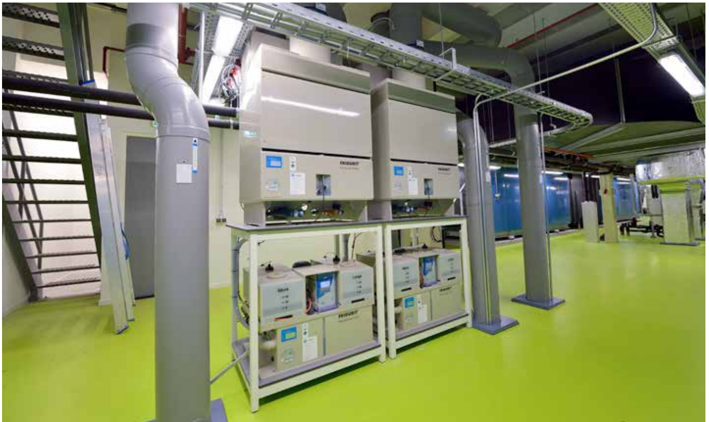
FRIDURIT Abluftwäscher C180 mit FRIDURIT Neutralisationsanlage zur Behandlung des chemisch belasteten Abwassers aus dem Abluftwäscher.
